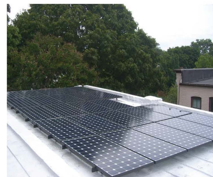
20kWp PV Array
