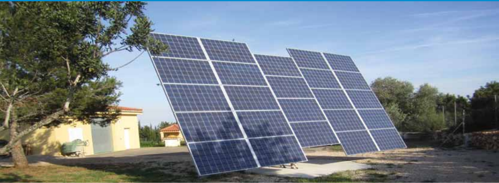
Calig, Spanien: Netzgekoppeltes Haus mit Quattros und BlueSolar-Netz-Wechselrichtern.
